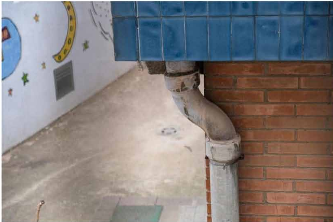
Detalle de una bajante de fibrocemento, en una escuela de Badalona. / GEORGINA ROIG
